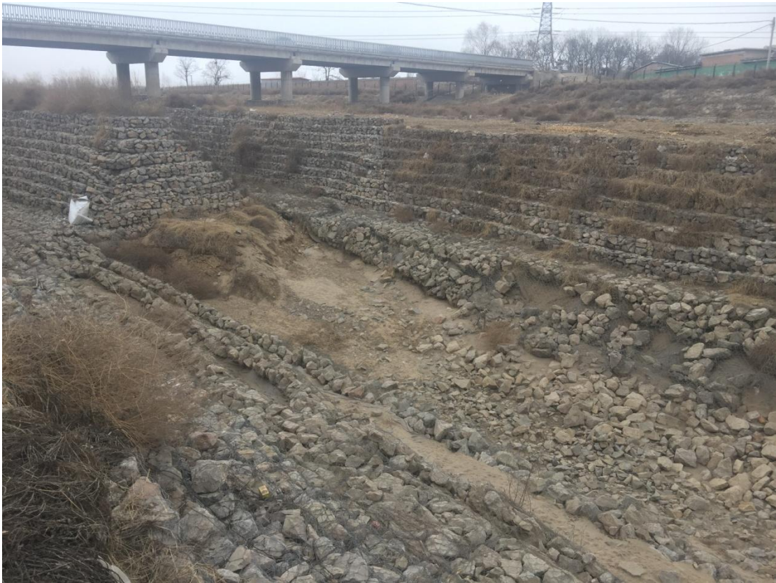
图 1-3 水毁的右岸坡、中墩和河底冲沟
