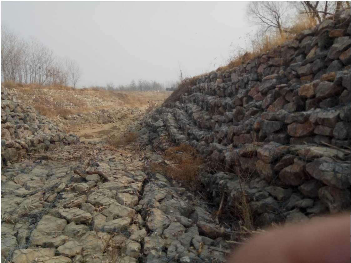
图 1-6 变形的右岸护坡、河底
