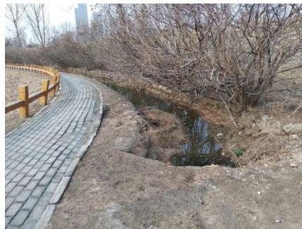
图 2-6 排水渠边坡裸露现状图
