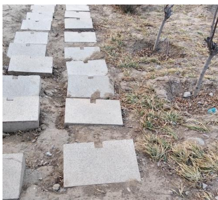
图 2-3 边坡处巡视步道破损现状图
