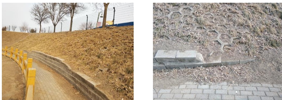
图 2-7 现有植草砖护坡及挡土墙已损坏
