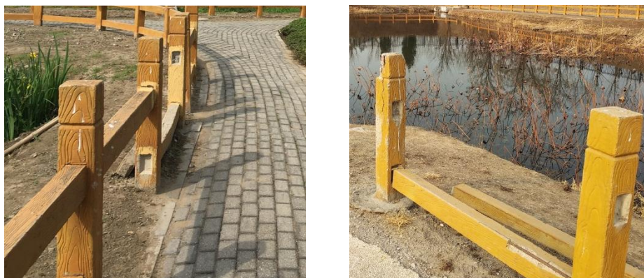
图 3-5 破损栏杆现状
