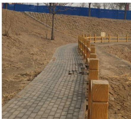
图 2-4 现有管理园路破损现状图
