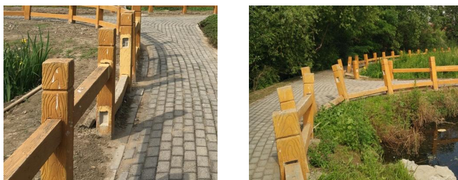
图 2-8 现有栏杆破损现状图
