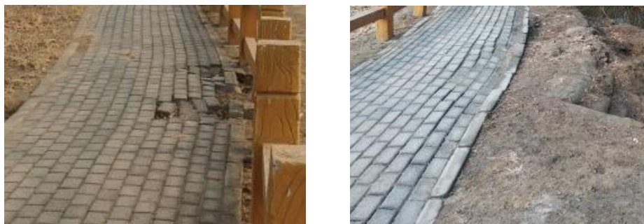
图 3-4 破损管理路现状
