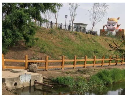
图 3-7 裸露边坡夏季现状
