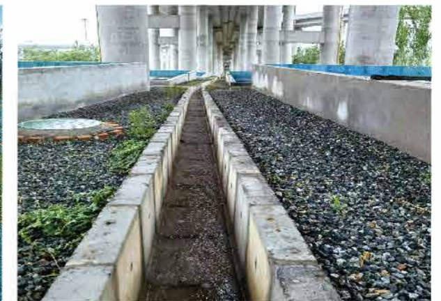
延崇高速雨水集蓄设施
