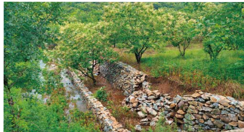
小流域干砌石挡墙损毁
