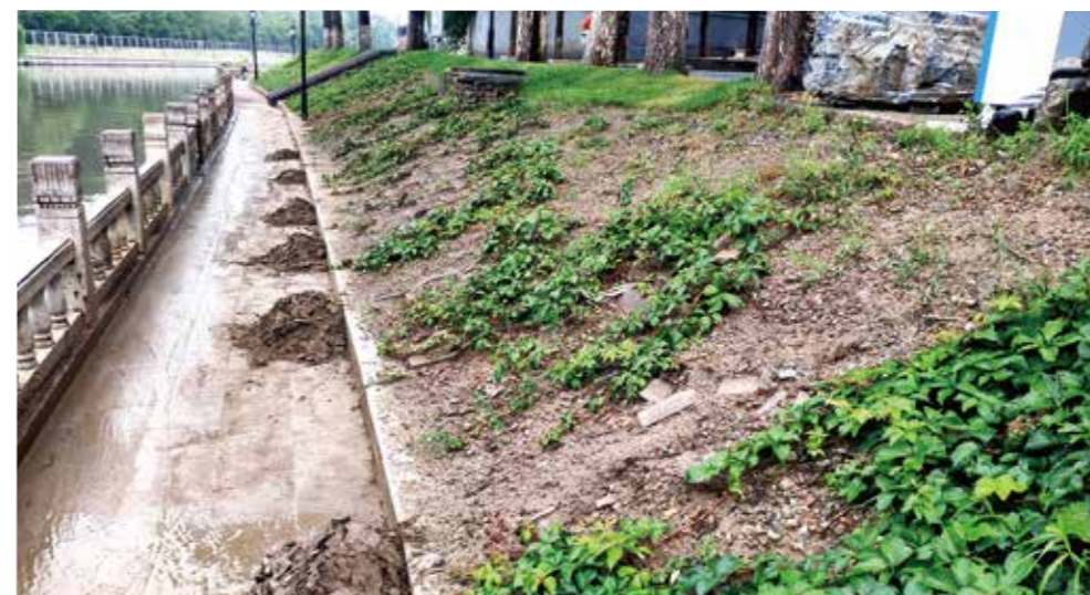
雨后边坡冲刷和路面淤积
