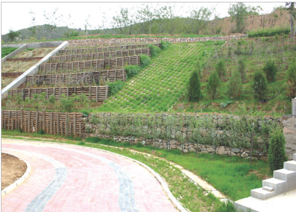
上辛庄开发建设项目试验示范基地边坡防护—木档桩水平护坡、植被石笼挡墙等
