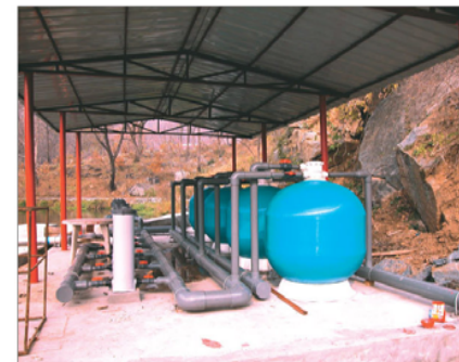
怀柔田仙峪鱼池废水处理设施
