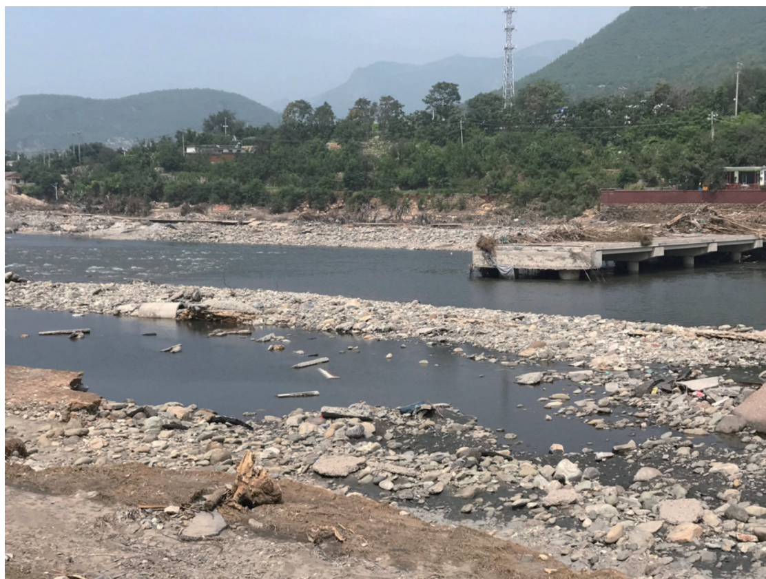
图 11 “23·7”流域性特大洪水后拒马河水毁情况
