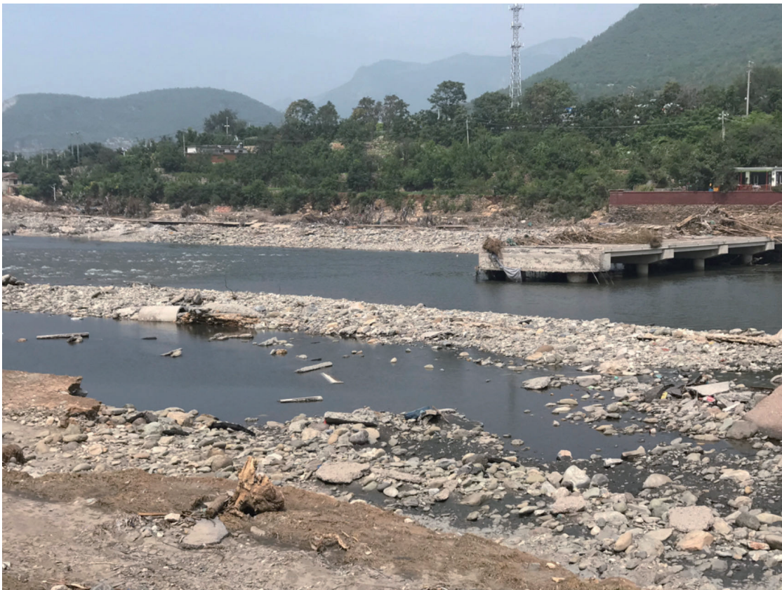
图 11 “23·7”流域性特大洪水后拒马河水毁情况
