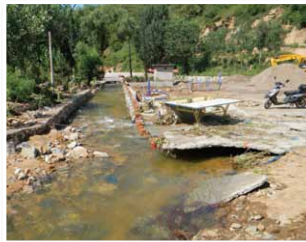
密云县巨各庄镇水树峪村被冲损的排洪渠
